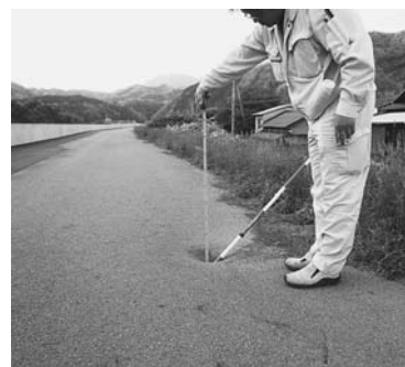
陥没した浜原堤防道路
